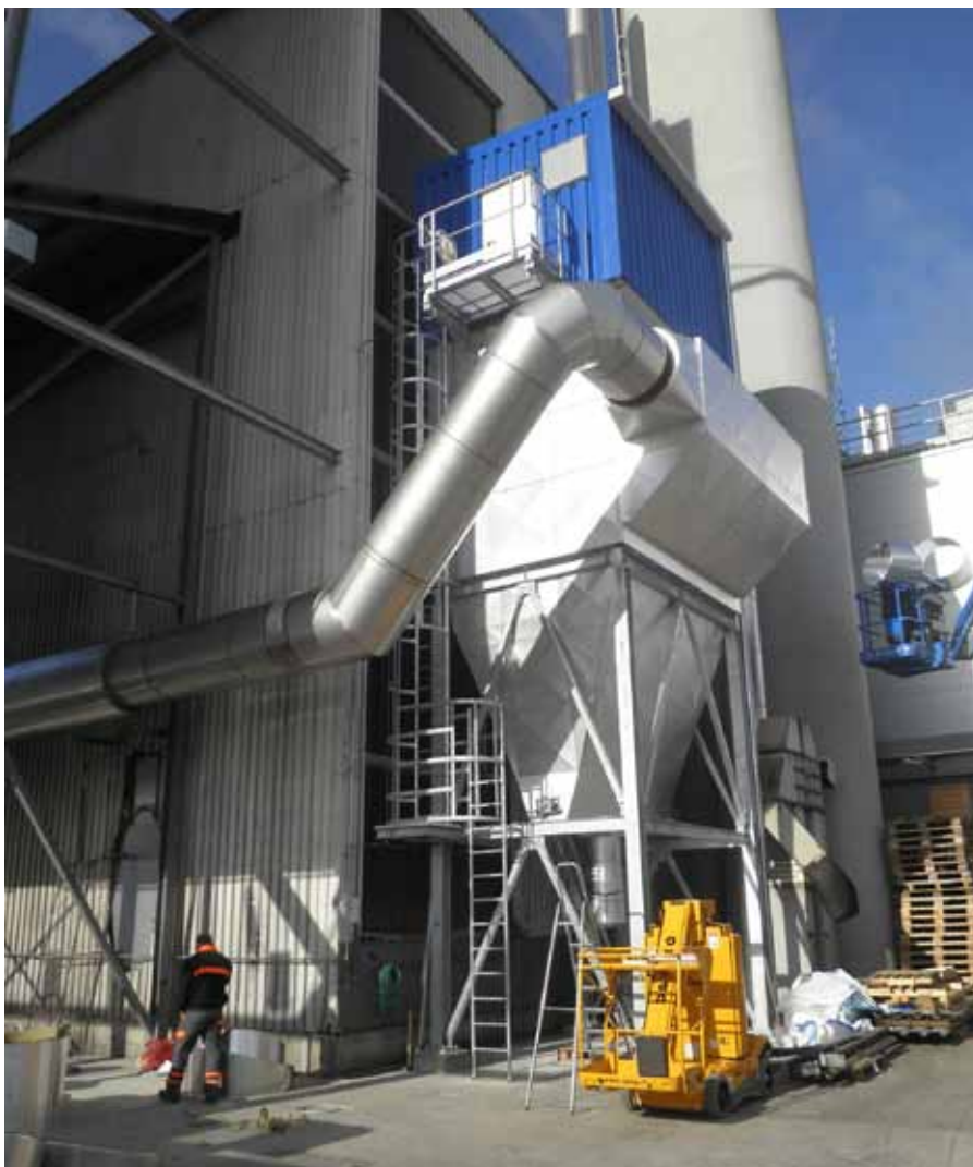
1. Anlage der neuen kompakten Filtertechnologie.
